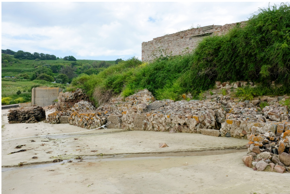
Fig. 6 : Le mur de la courtine est effondré sur la plage (Cliché. Cl. Brémont)
