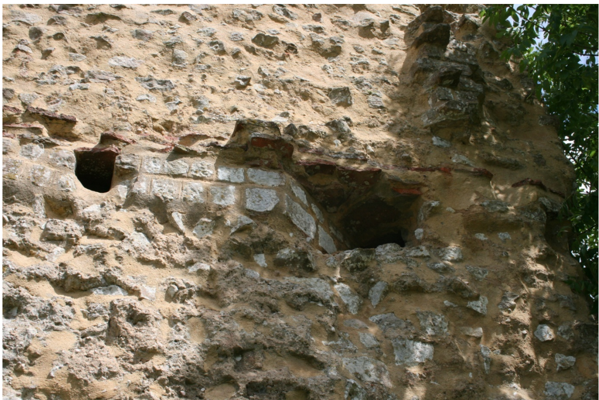
Figure 51 : Les indices de l'arrivée de l'aqueduc dans les murs des thermes nord (clichés L. Jeanne).
