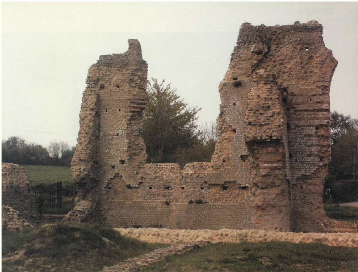
Vue intérieure de la baie du tepidarium T1 en 2004. Photo © E. Follain.
