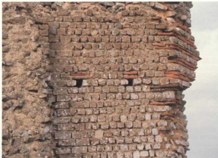
Parement en opus vittatum et cordons de terres cuites au niveau de la baie. Photo © Th. Lepert.
